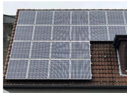
PV-Anlage auf Reihenendhaus nach Rückbau der falsch verlegten Module
