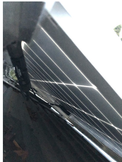
Blick unter eine Reihe PV-Module mit Steckverbindungen (exemplarisch)
