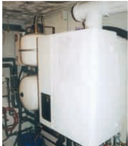
Abb. 28: Moderne Brennwertkesselanlage mit solarer Unterstützung der Warmwasserbereitung
