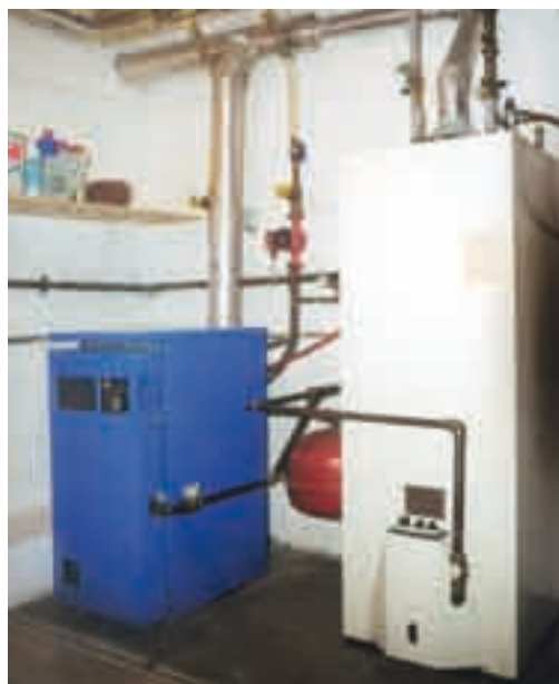
Abb. 13: Energetisch veraltete Heizkessel-Anlage in einem Einfamilienhaus
