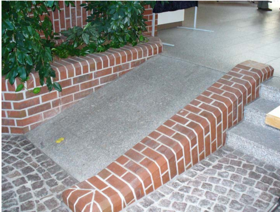
Abb. 2. Beispiel einer nicht normgerecht ausgeführten Rampe
