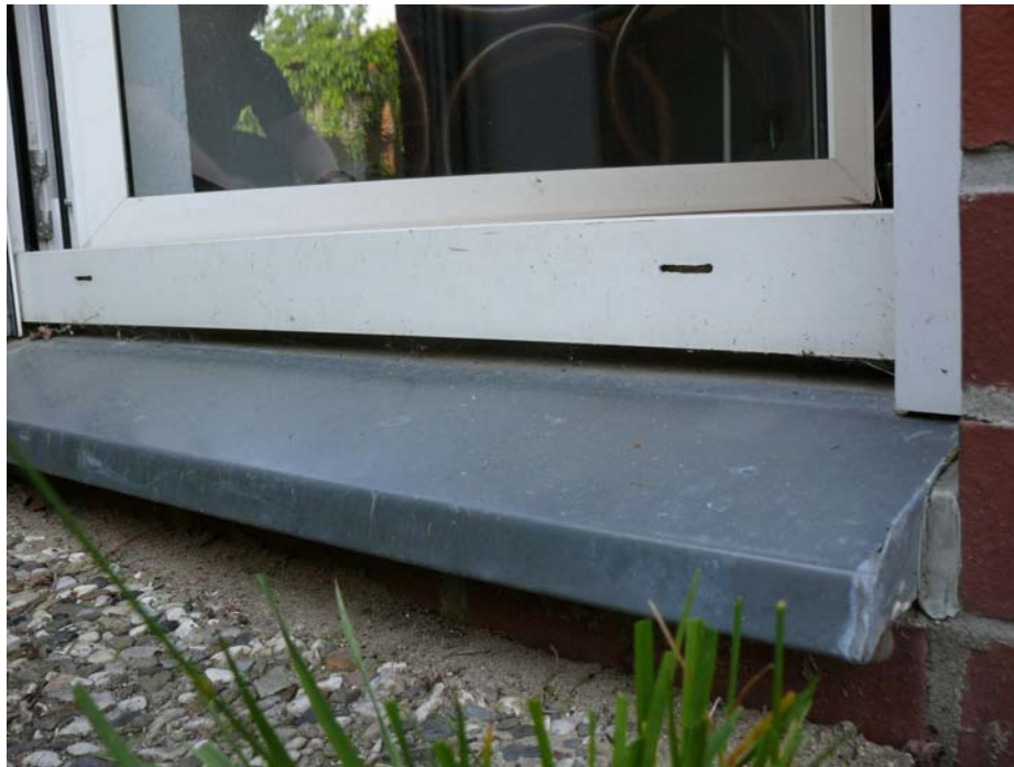
Abb.1: Beispiel einer nicht barrierefreien Terrassentür
